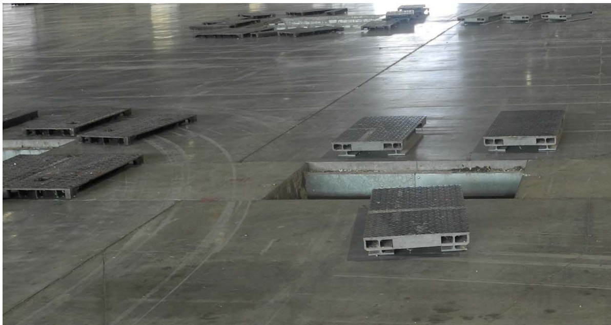
Foto 1- Chiusini in acciaio non oggetto di rinforzo
